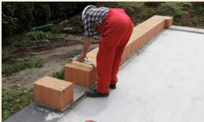
2. Ziegel für Ziegel knirsch versetzen und anschließend mit Wasserwaage und Gummihammer ausrichten.
