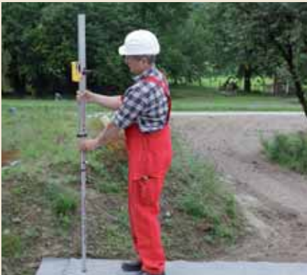
1.4 Um die Mindesthöhe der Mörtelschicht festzulegen, wird mit einem Nivelliergerät oder einer Schlauchwaage der höchste Punkt der Betonplatte ermittelt.
