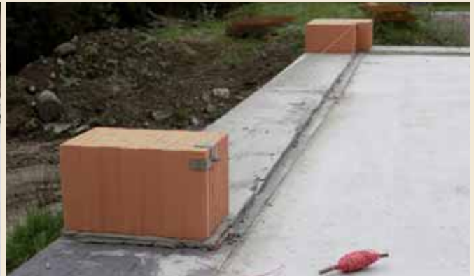
2.2 Das Setzen der Ziegel beginnt an den Zwangspunkten (Ecke, Tür- oder Fensterlaibung o. ä.). Daran die Richtschnur anlegen.
