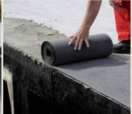
1.3 Damit keine Feuchtigkeit aufsteigt, wird in das Mörtelbett eine Sperrschicht (z. B. besandete Bitumenbahn, kunststoffarmierte Dichtungsbahn) eingebettet.
