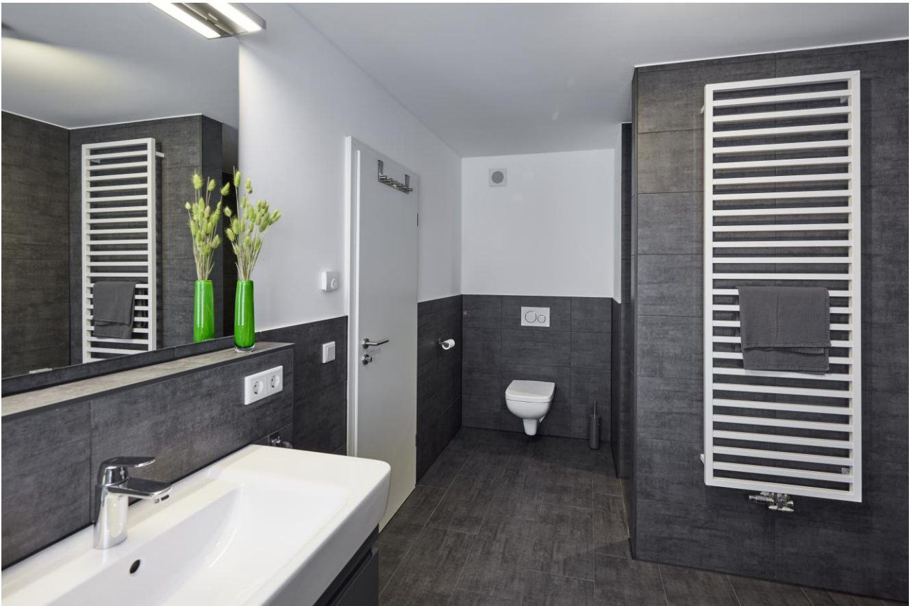
Bild 10: Bei den beiden Badezimmern handelt es sich um sogenannte Ablufträume, dort wird die verbrauchte Luft durch das Lüftungsgerät über Designgitter abgeführt und nach draußen geleitet. Design-Heizkörper Zehnder Subway sorgen hier zudem für behagliche Wärme und vortemperierte Handtücher.
